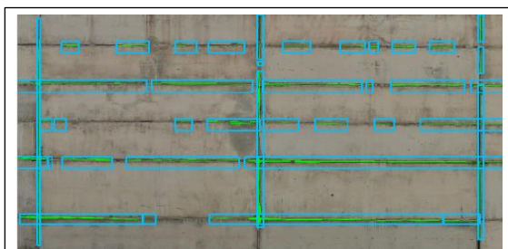
Рис. 6. Пример обнаруженных разрушений швов
